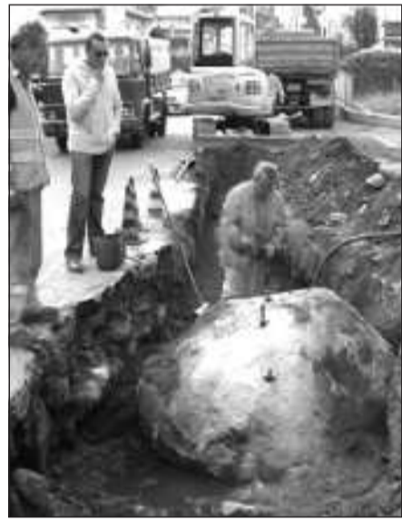
Il ponte sul fiume Oglio tra Malonno e Berzo Demo interessato da un paio d'anni dal cantiere di riqualificazione. A sinistra, uno dei massi che stanno rallentando i cantieri lungo la Ss42
